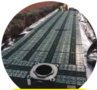
Rigofill inspect et régulation ☺ Longueville les Metz (57)
